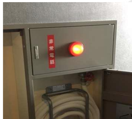
各フロア: 消火栓 3か所設置
