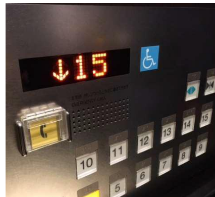
エレベーター内: 非常呼出ボタン
