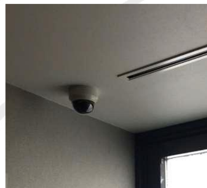
廊下:監視カメラ(CCTV)
