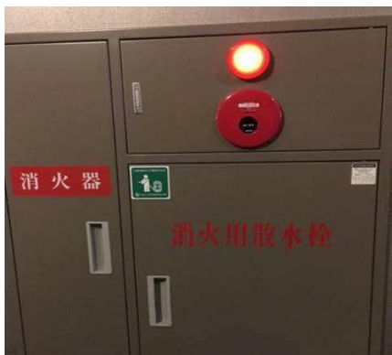
廊下:消火器・ 非常ボタン・消火栓
